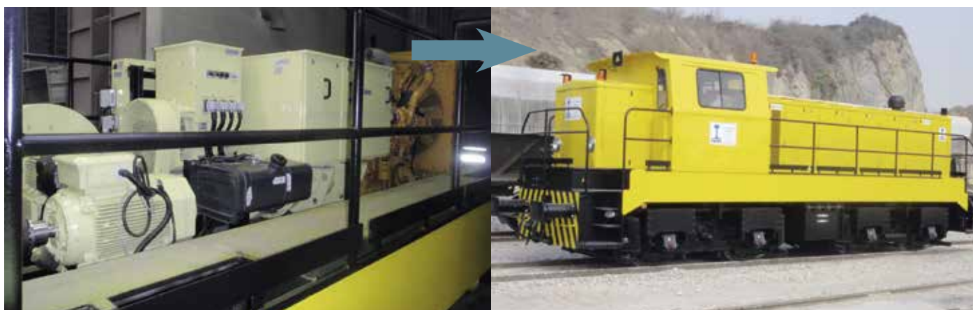
Compartiment moteur diesel avec alternateur de locotracteur BB Favet Girel 72 t Diesel engine with alternator of a locomotive BB Favet Girel 72 tons
