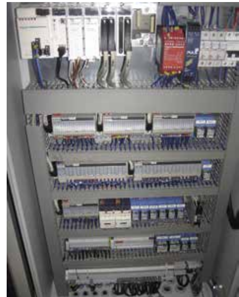
Armoire électrique nouvelle génération avec automate New generation of control cabinet monitored by an automatic
