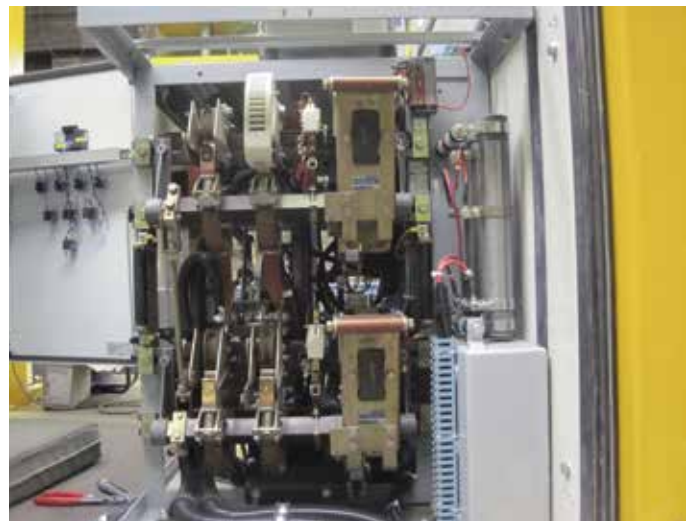
Armoire de puissance neuve Brand new power cabinet
