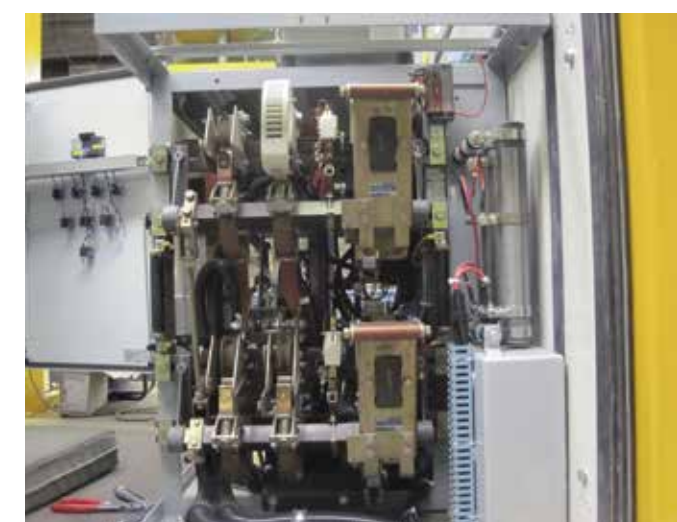
Armoire de puissance neuve Brand new power cabinet
