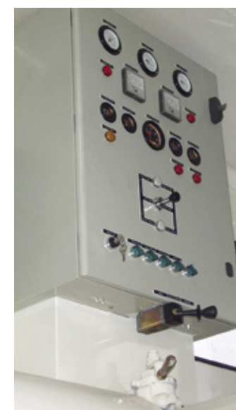
Armoire électrique rénovée Electrical cabinet reconditioned as new
